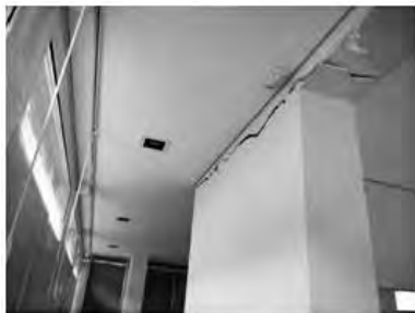
Fig.3. Falla presentada en muro interno
